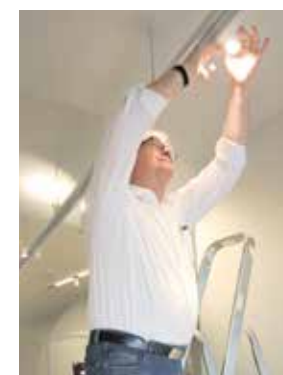
Mann für alles. Andreas Ledl (Präsidialabteilung) koordinierte die Sanierung. Hier: Einstellung der Spots.
